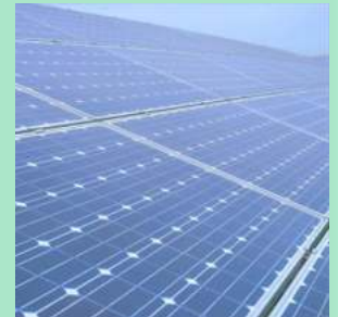
Solar PV Modules
